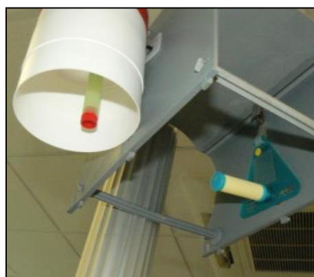
Tubes installés pour la collecte
